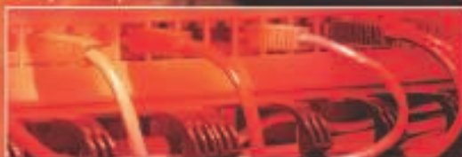
Okablowanie strukturalne i światłowodowe
