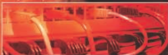
Okablowanie strukturalne i światłowodowe
