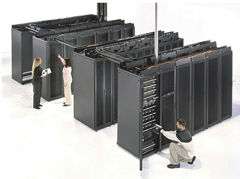
Serwery typu Blade w szafach
